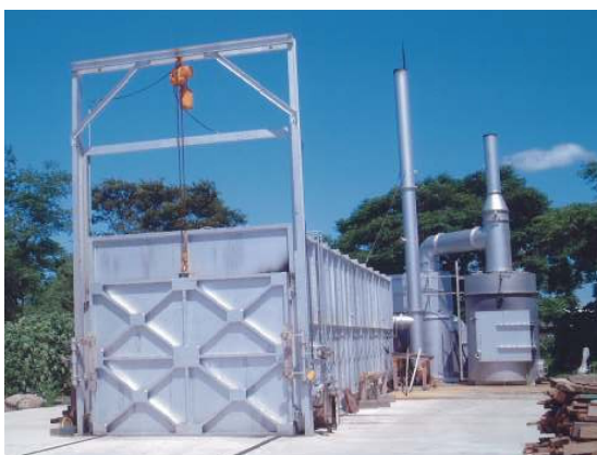
燻煙処理装置(全景): 特許第 3449685 号
